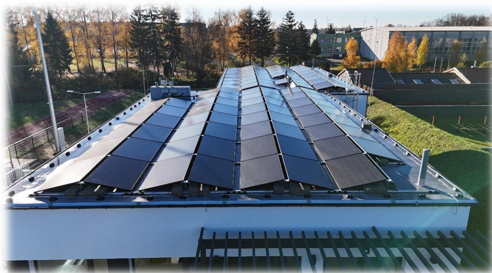
Ryc. 23 Obiekt stadionu zaopatrzony w panele fotowoltaiczne oraz pompy ciepła
