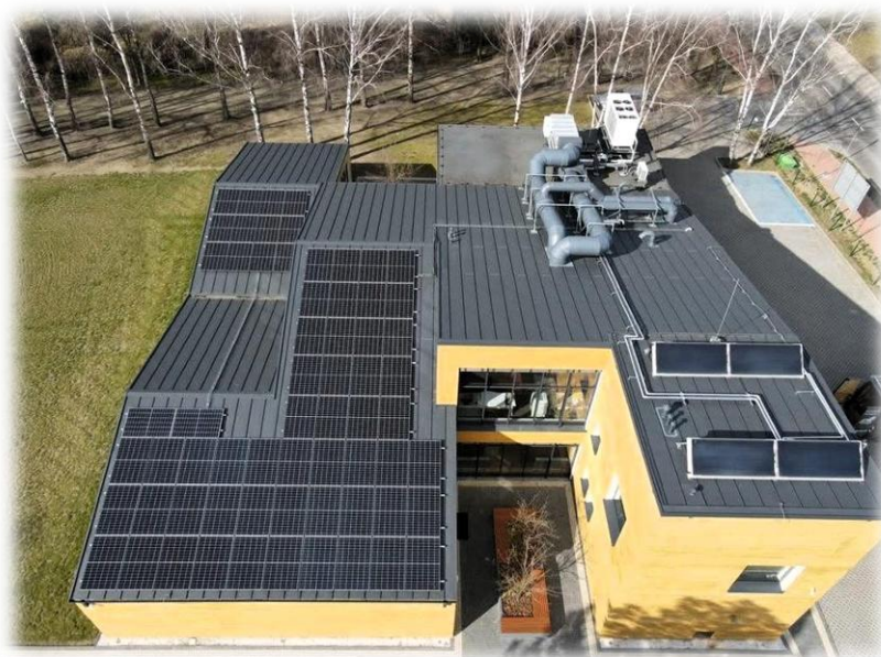
Ryc. 18 Panele fotowoltaiczne na kolejnym budynku gminnym
